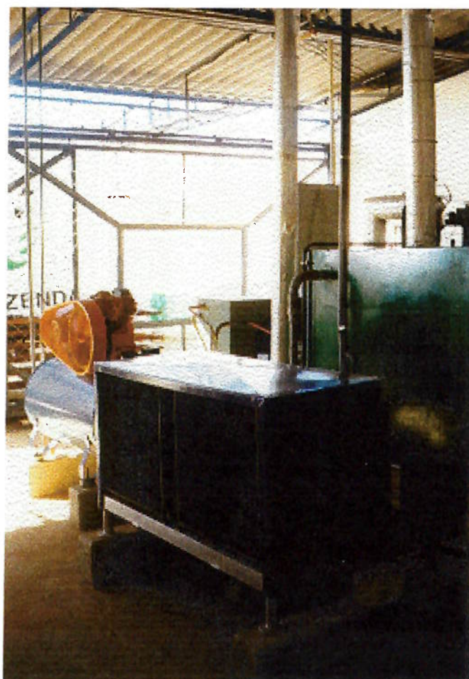
Foto 11 - Condensador na casa de máquinas do laticínio (Fazenda São Judas)
