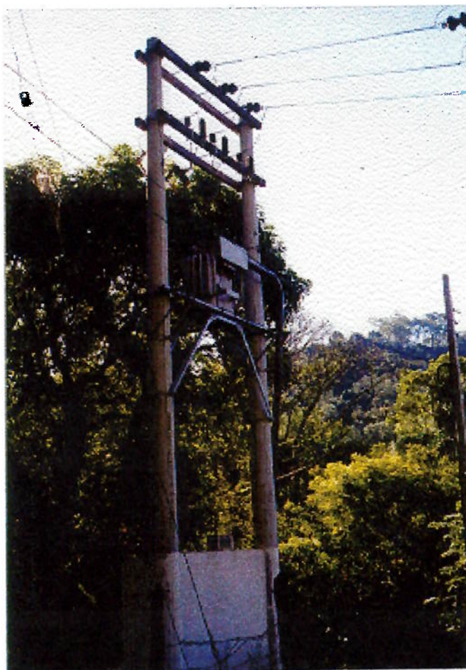
Foto 15 - Central de força (Fazenda São Judas)
